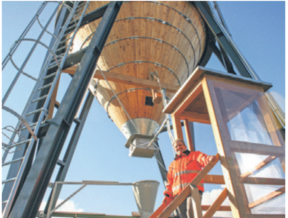
Im Werkhof konnte im 2014 ein neuer Salzsilo in Betrieb genommen werden.
