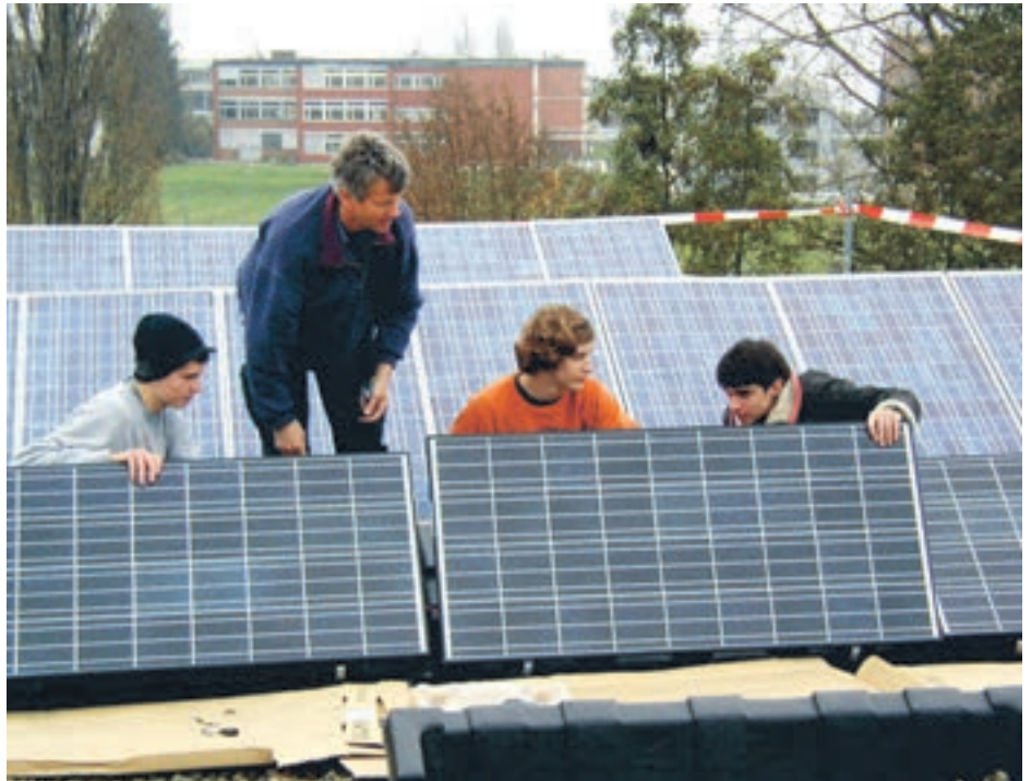
Der Solarverein hat schon auf den Dächern der Kantonsschule (Bild), der Sekundarschule und der Firma Maron Solaranlagen erstellt. Nun soll auch das Werkhofdach solar genutzt werden.
