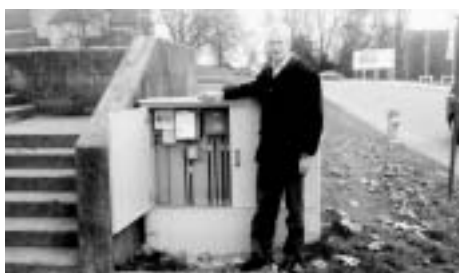
KARO-Geschäftsführer Louis Tschümperlin vor einer modernisierten Kabine
