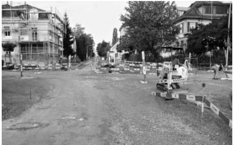
Für Passanten und Anwohner bald ein gewohntes Bild: Die Sanierung der Salmsacherstrasse geht zügig voran. (Bild: Markus Bösch)
